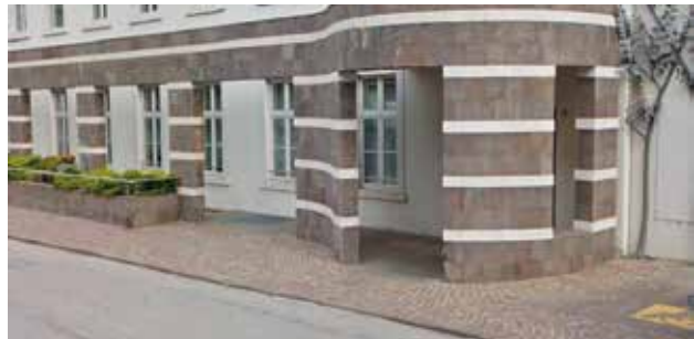
FOTO n. 9 - Via Santa Maria (entrata Municipio) Manca raccordo strada-marciapiede
